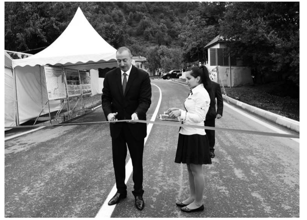
aidir və ikizolaqlıdır. Yolun inşası zamanı müxtəlif diametrlə suötürücü borular tikilib, iki körpü keçidi inşa olunub. Bu yolun tikilməsi bölgədə sərnişin və yük daşınmasını xeyli yaxşılaşdırmağa imkan verəcək. Həmçinin sözügedən avtomobil yolunun tikintisi yerli və xarici turistlərin ərazidə yerləşən istirahət mərkəzləri və yerli tarixi mədəniyyət abidələri ilə də tanış olmalarına şərait yaradacaq. Prezident İlham Əliyev yeni yolun rəmzi açılışını bildirən lenti kəsdi. Sonda xatirə şəkli çəkildi.
